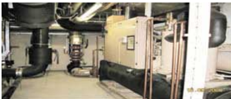
Enfriadora 750 kW Strabach Tower Viena
